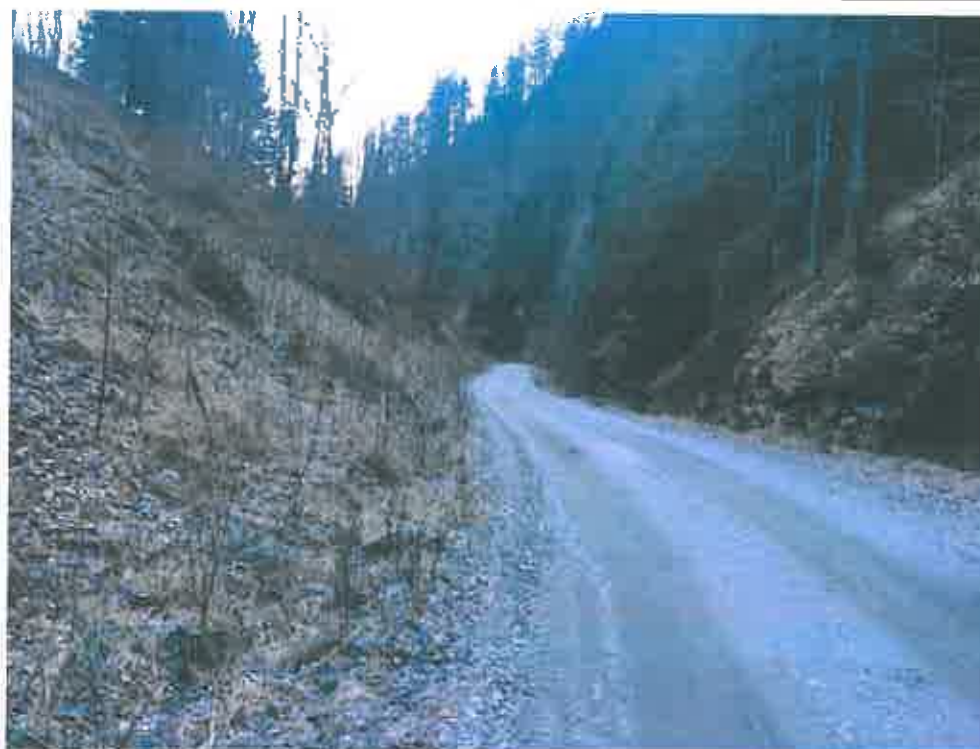
Fig. 12 Detaliu conductă de aducțiune îngropată captare Tia (conductă este amplasată în partea stângă a drumului aval de captare, în partea dreaptă fiind râul Tia)
