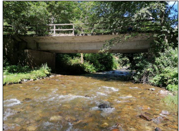
Aspecte din stația T7
