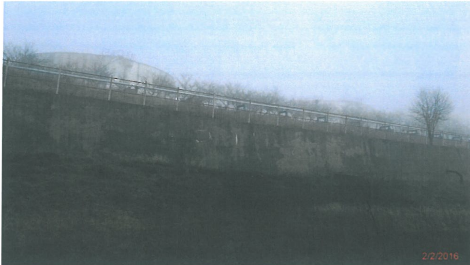
Fig. 7 - Zid de sprijin betonat pentru platformele C3 si C4
