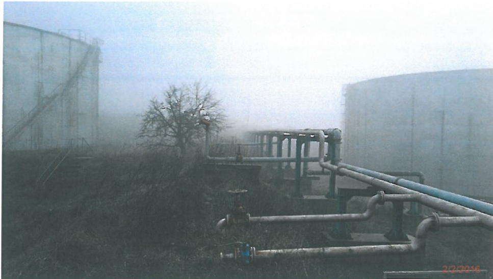
Fig. 4 - Conducte supraterrane pe fundatii din beton
