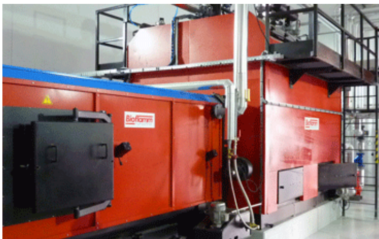
Foto nr.1. Vedere generală a cazanului WVTerm GmbH
