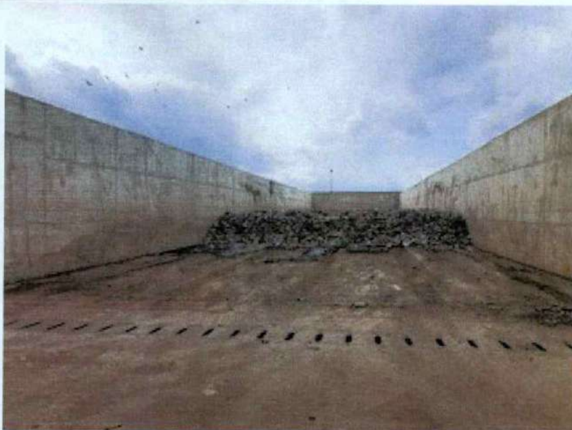
Fig.8. Zona celule de biostabilizare
