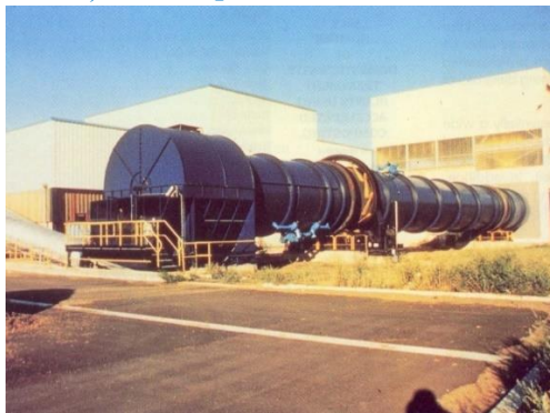
Figura 7-13 Instalație de compostare dinamică cu tambur de alterare
