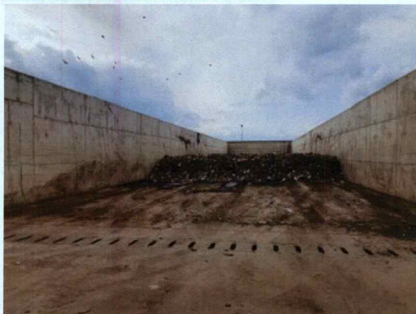
Fig.8. Zona celule de biostabilizare
